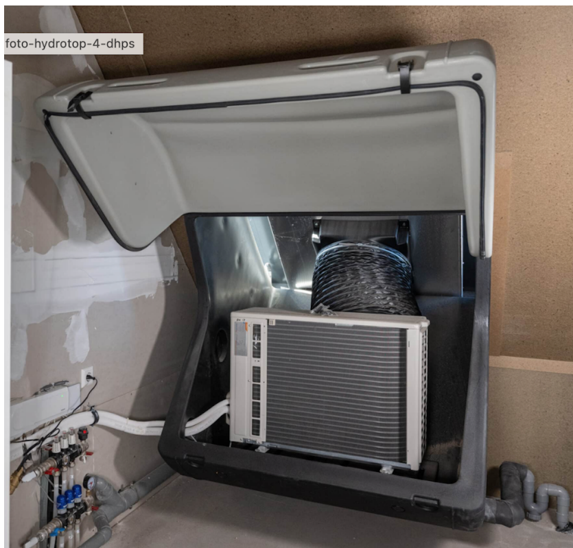
Afbeelding Opstelling van de warmtepomp binnenshuis met luchttoe- en -afvoer door het dak.
