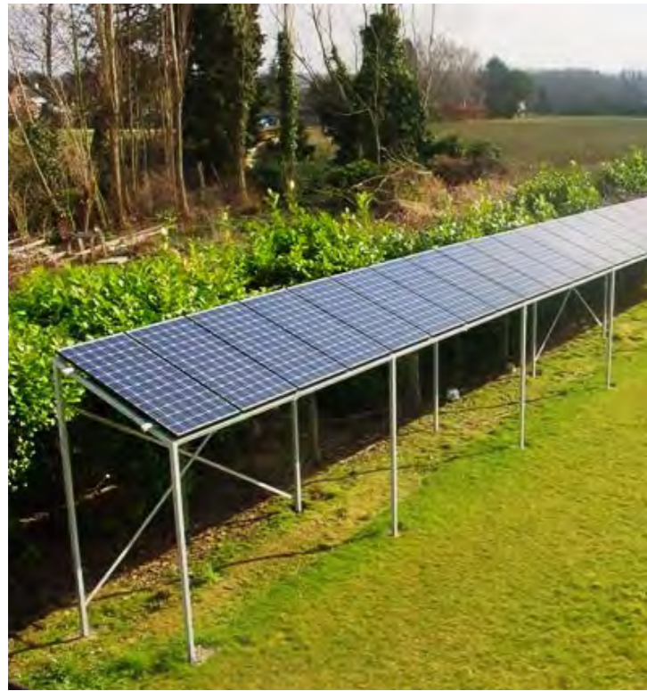
zonnepanelen langs de paden - bron: BDP.
