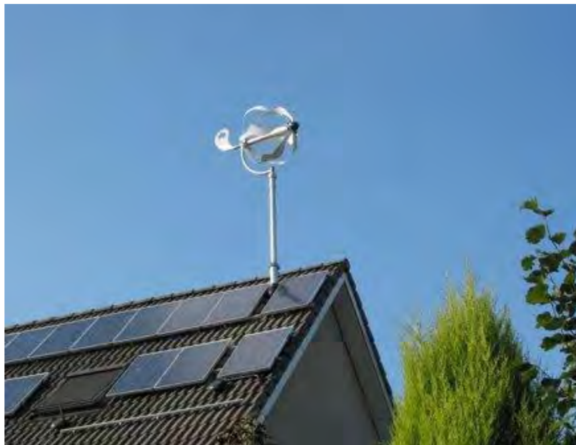
smalle windturbines op particuliere daken in de directe omgeving van de Linies
